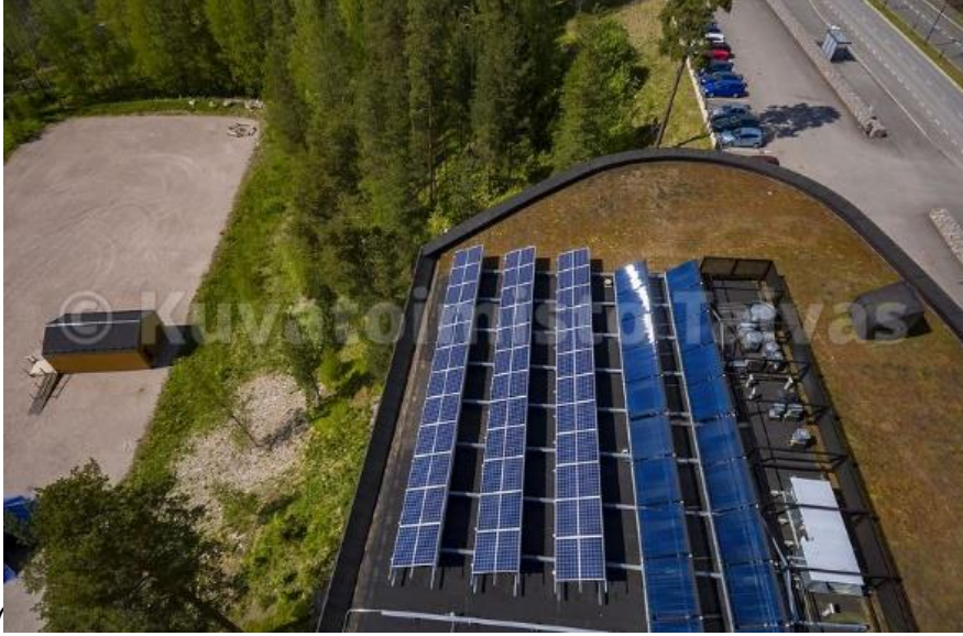
Fig. 7.48. Solar panels on the roof (Kuvataivas, n.d.)
